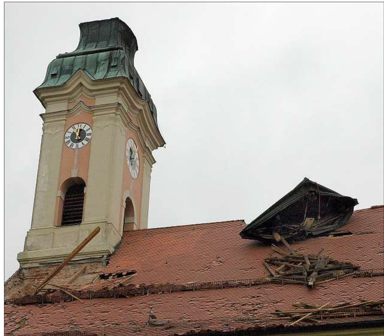
Erschreckend auch der Anblick vom Klosterinnenhof aus: Wie ein großes Fischmaul gähnt die abgebrochene Turmspitze vom Dach. Unterhalb des Turms klafft ein großes Loch, das Einblick gibt bis ins Gemäuer.
